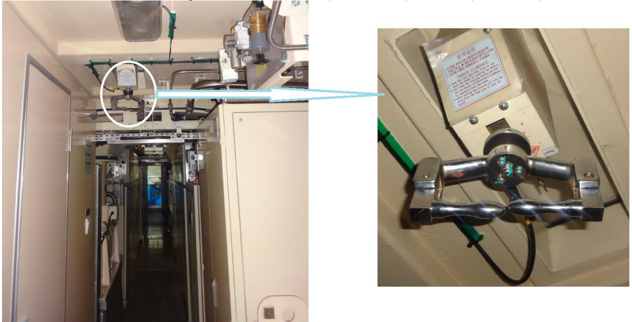
图 18 - 高压隔离开关 QS-HV 的布置 (on—接通, off—断开)
