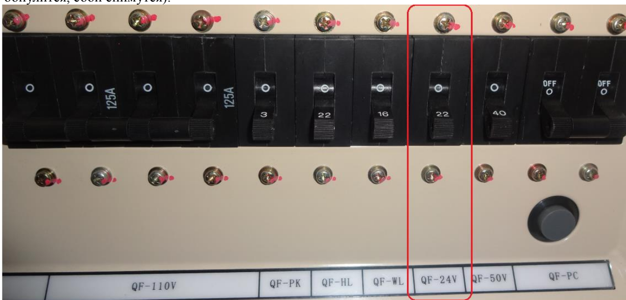
图 67- 充电柜断路器«由充电装置供电的 24V 电路 QF-24V»的布置
