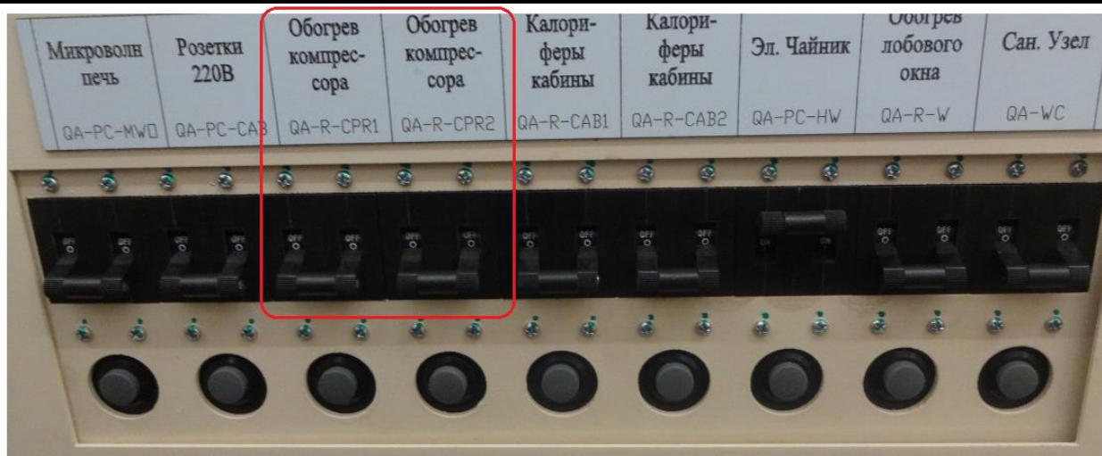
图 66 - 断路器«主压缩机 QA-CPR»在低压装置柜上的布置
