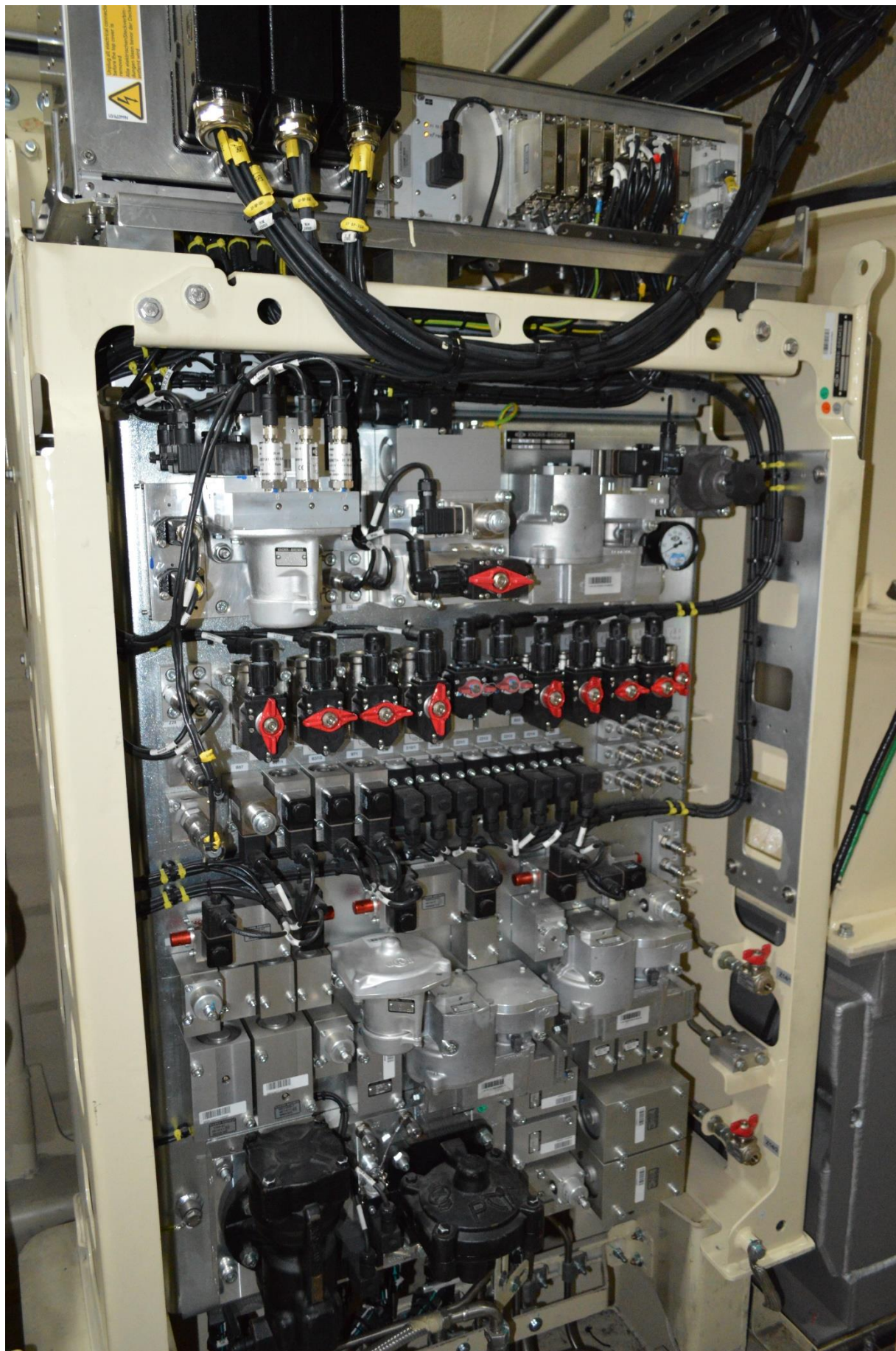
Рисунок 28 – Общий вид шкафа тормозного оборудования
