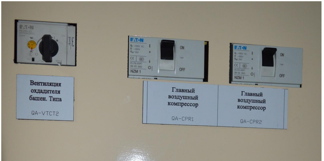
Рисунок 63 – Расположение автомата «Главный воздушный компрессор QA-CPR» на шкафу низковольтной аппаратуры
