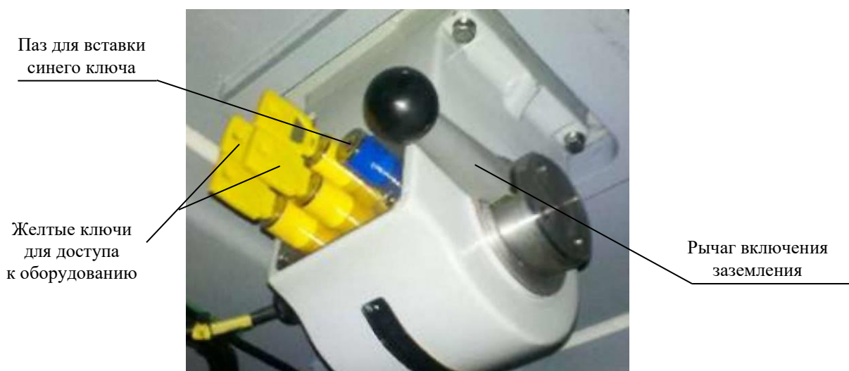
Рисунок 5.12 – Ключевой коммутатор крышевого заземлителя
