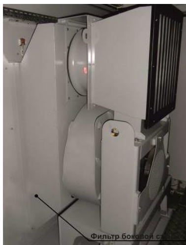
Рисунок 8.2 – Место установки фильтра очистки воздуха
