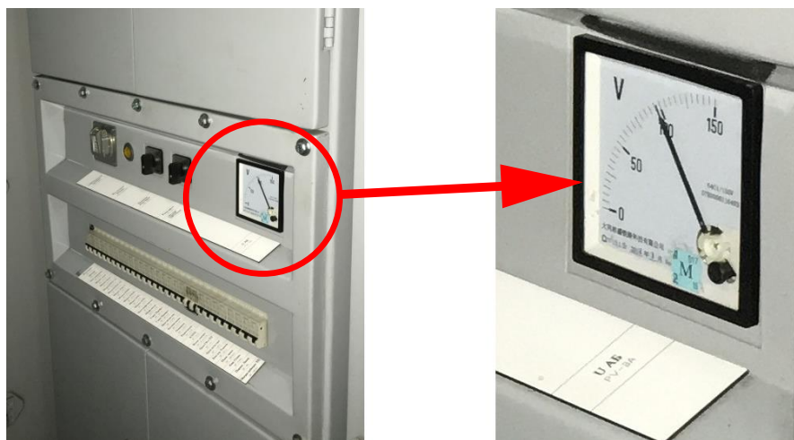
Рисунок 18.8 – Расположение вольтметра цепей управления «UAB PV-BA» в шкафу МСУД
